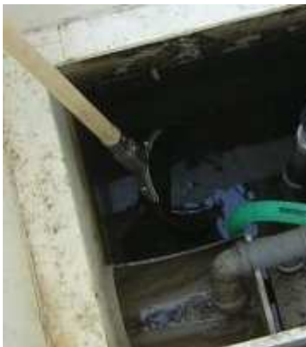
vybrání vyflotovaného kalu z dosazovacího prostoru
