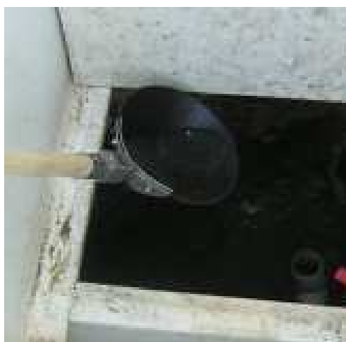
přelití vyflotovaného kalu do kalového prostoru
